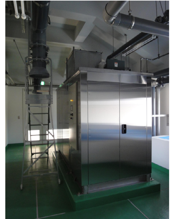
農業集落排水処理場で運用 の弊社アクアシステム (ウンチも処理しています。)
